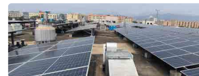
河原工場（中国）に設置された太陽光パネル
